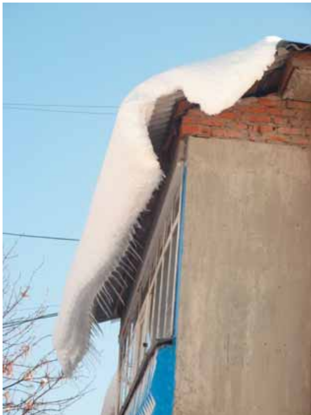
Рис. 4. Кровля этого дома совсем «свежая» — сделана летом. Снега зимой было мало, поэтому чрезмерно большой свес шиферной кровли пока еще держит сползающий снеговой мешок. Но что будет лет через 5–10, когда шифер состарится или снега вытадет больше?
